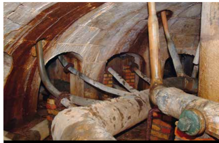
Vue de l'araignée, Système hydraulique sous le bassin de Latone
